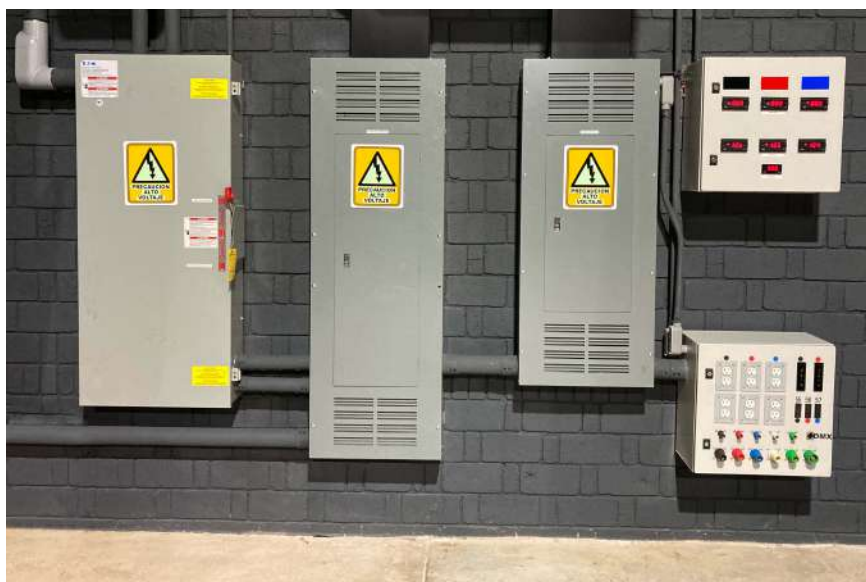
IMAGEN 10 | CAJAS ELÉCTRICAS EN FORO
